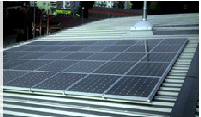
Solaranlage auf dem Hausdach der Familie Harenberg-Buob in Estavayer-le-Lac
