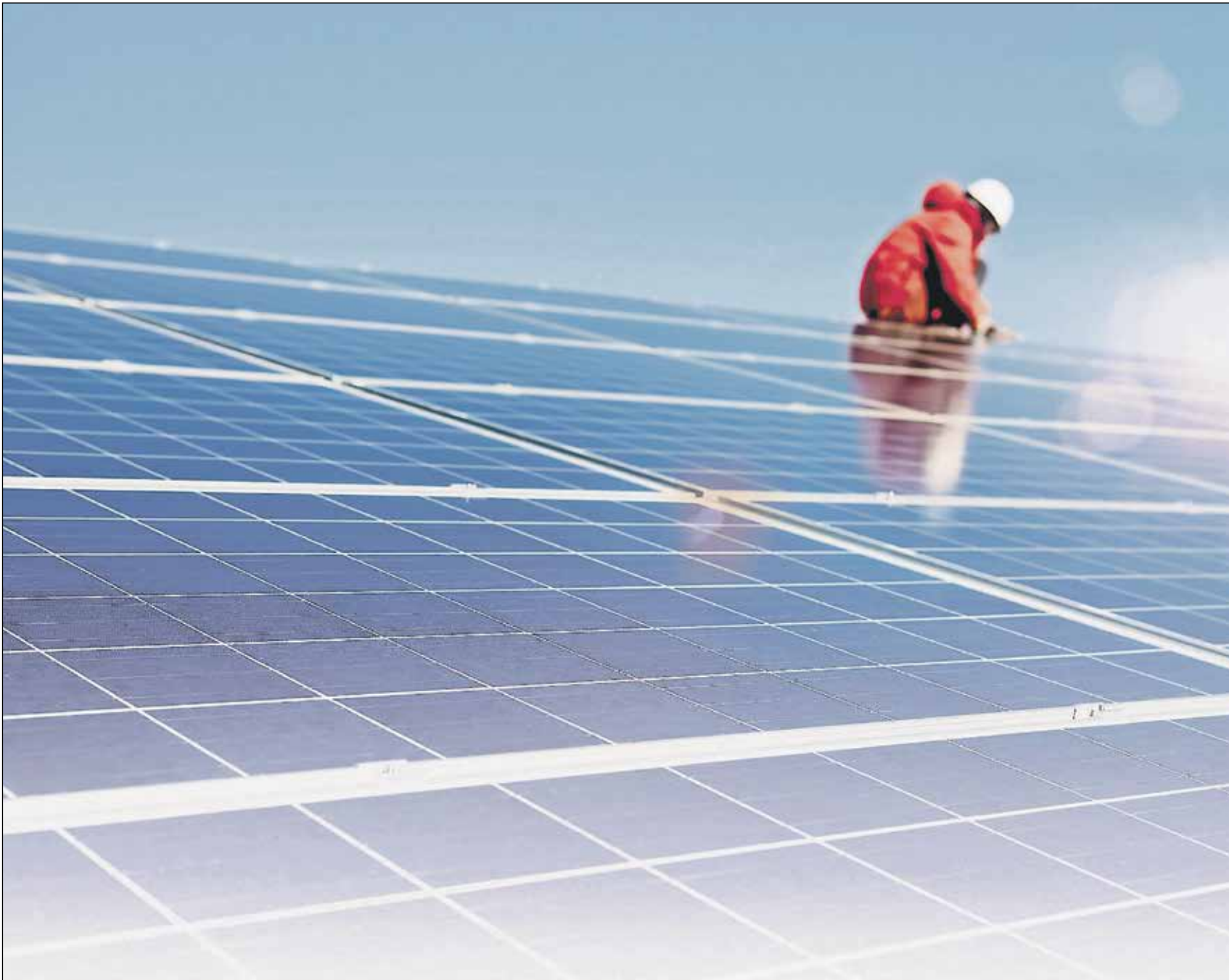
Photovoltaikanlage auf dem eigenen Dach: Antworten auf Fragen zur Technik und zu Fördergeldern anlässlich der Infoveranstaltung vom Mittwochabend, 2. November in Lenzburg. (Bilder: zVg.)
