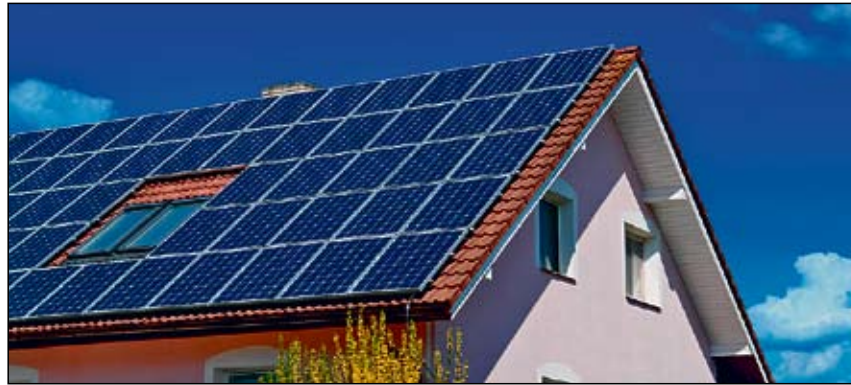
Eine Fotovoltaikanlage auf dem eigenen Dach kann auch in der Nacht Strom liefern – mit einem Energiespeicher.
